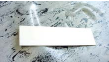
Рис. 11. Образование пузырей при несоблюдении требований по укладке
